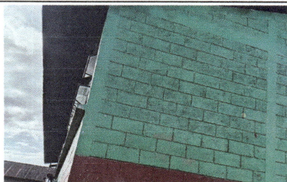
Foto 2: Paredes de escuela con deterioro.
