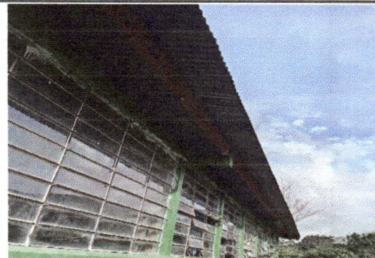
Foto 4: Estructura de las ventanas del edificio en mal estado
